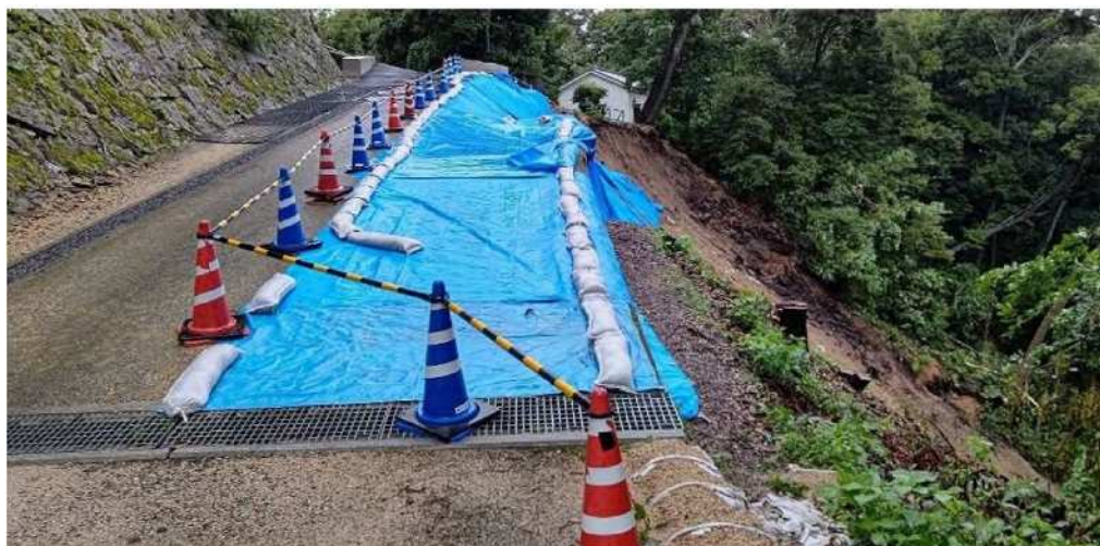
＜被災直後の道路状況 午前6：20頃＞
