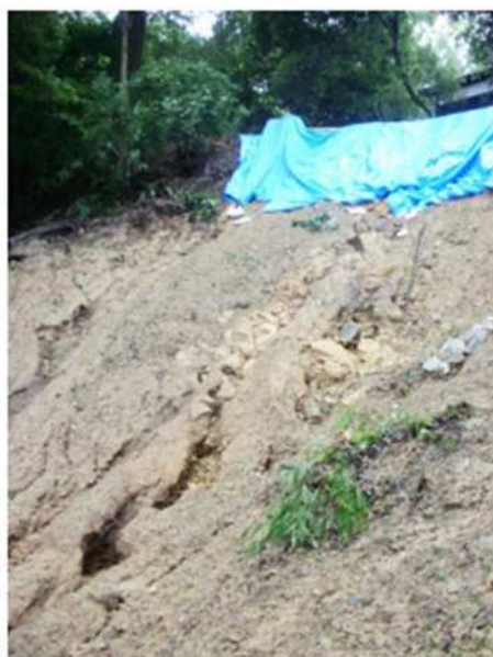
源頭部のすべり面には砂岩が見られる
