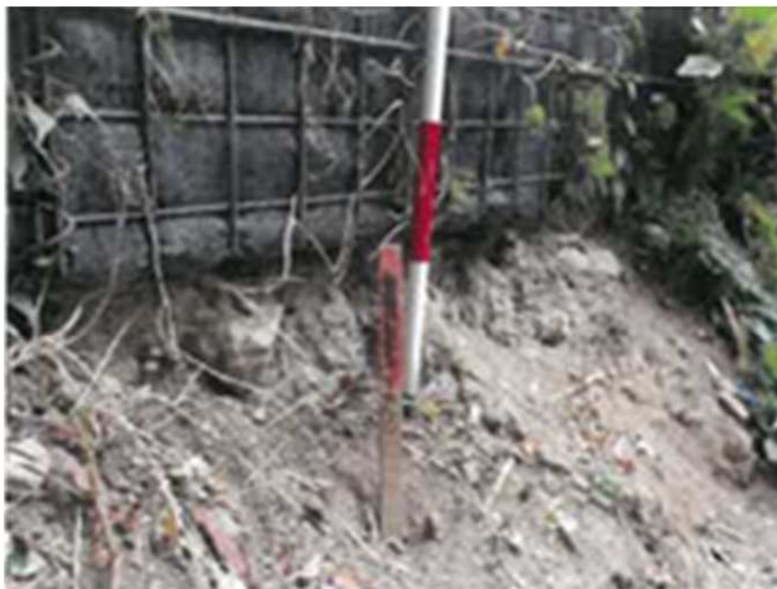
⑧YSP-20+6.2 付近 カゴ枠下部地盤崩壊
